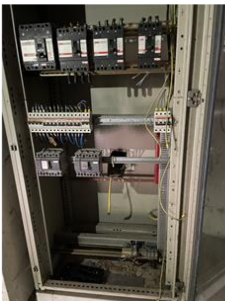
foto 11 – zona cabina elettrica: quadro divelto
