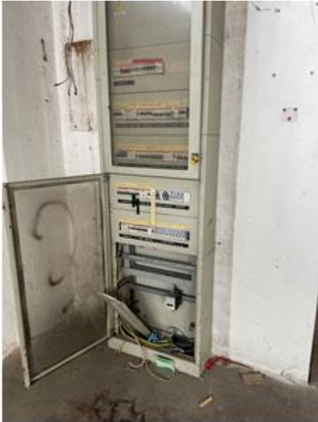
foto 1 – zona magazzino: quadro divolto
