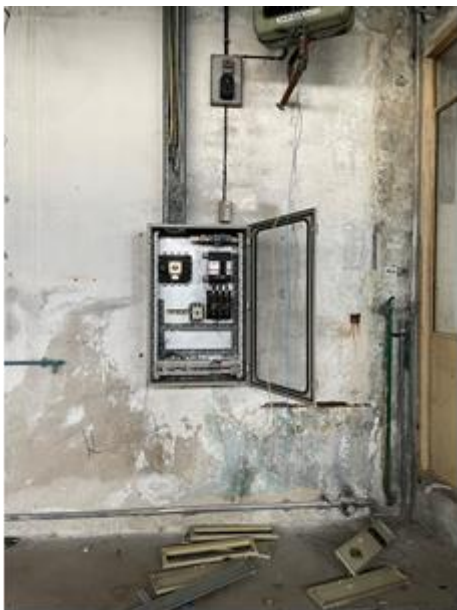
foto 5 – zona magazzino: quadro divelto
