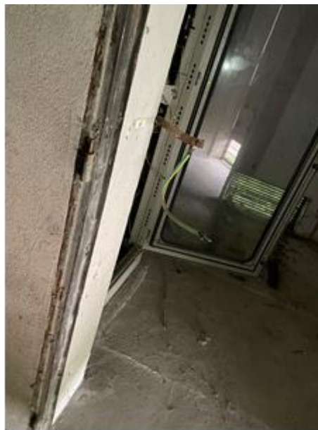
foto 10 – zona cabina elettrica: quadro divelto
